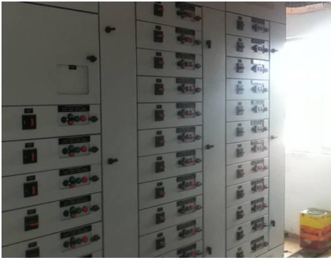
Sistema Elétrico de Bombeamento de Estação Elevatória Efluente
