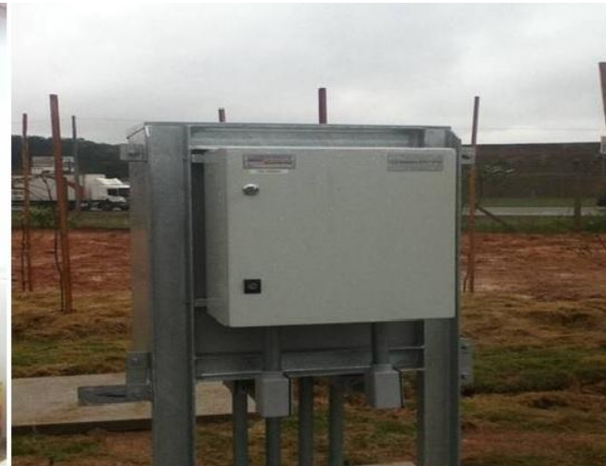
Painel de Comando e Proteção e Painel de Transmissão de Sinal via Radio Dispensando Transmissão Tradicional de Comando via Cabos por 1km de distância
