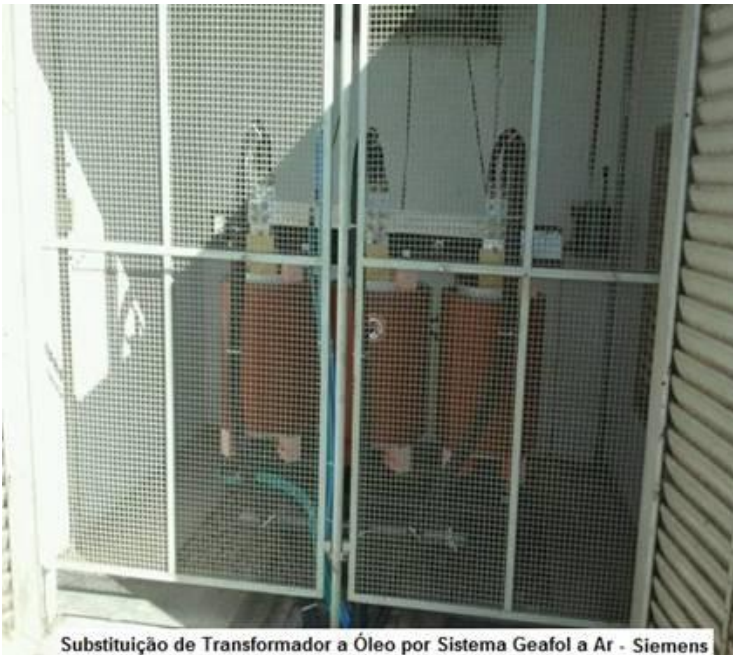
Substituição de Transformador a Óleo por Sistema Geafol a Ar - Siemens
