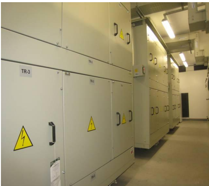
SE J. CALVINO TRANSFORMADORES 3 X 1.000 KVA 20KV/220V. IP20
