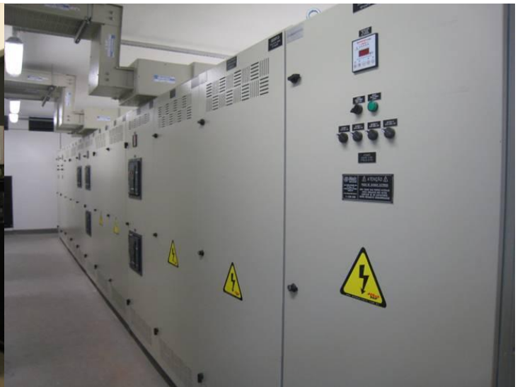
Sub. J.CALVINO 3.000kva parte QGBT 220v
