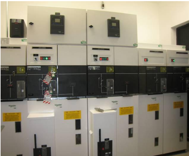
Sub. 49 PARTE NOVA – Cub.SF6 (Schneider)
