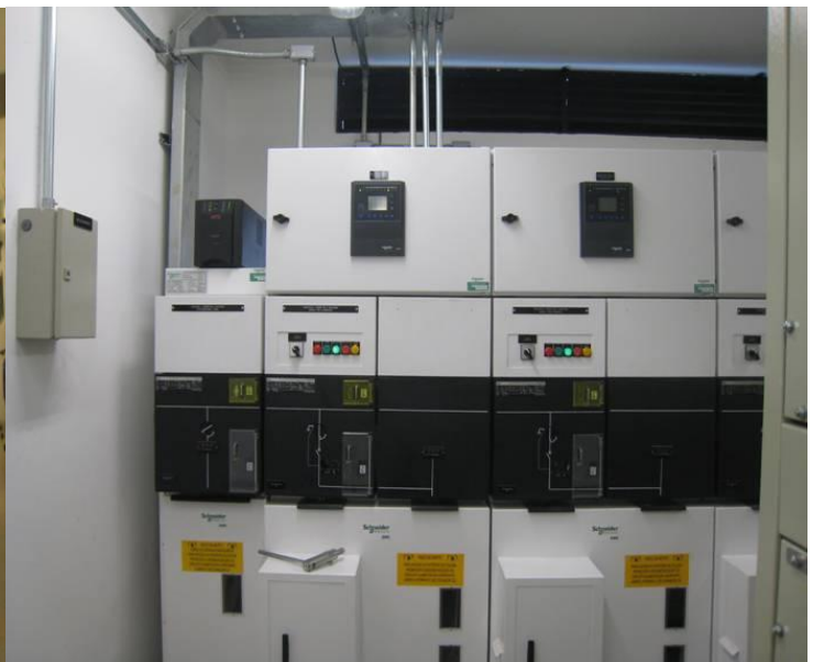
SE. J. CALVINO QGMT – 3.000 KVA 1 ENTRADA E 3 CUB. SAIDA .SF6 COM DISJUNT. MOTORIZ. SCHNEIDER
