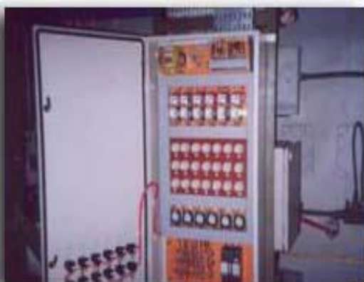
Sistema de comando e proteção elétrica
