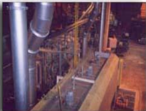
Vista superior com sistema de exaustão e ventilação
