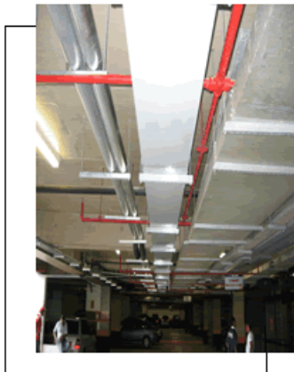
Infra-Estrutura e Suporte p/ Cabeamento Elétrico
