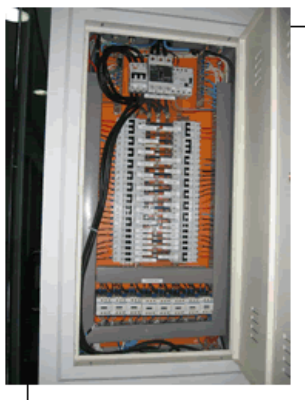
Quadro de Distribuição de Iluminação e Tomada do Andar
