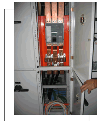
Disjuntor Geral de Medição Eletropaulo
