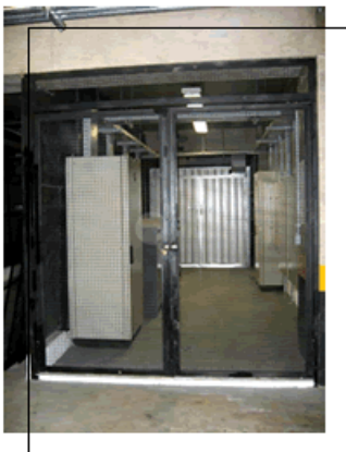
Sala de Painéis de Distribuição de No-Break e Redundância
