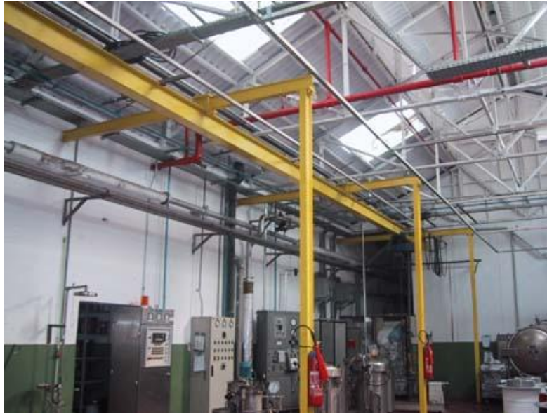
INFRA-ESTRUTURA ELETROMECAÂNICA PARA M. TINGIMENTO
